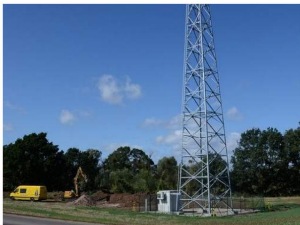
Der Funkturm für den Magdeburger Stadtteil Randau-Calenberge steht schon seit mehreren Wochen. Doch in Betrieb ist er noch nicht. Foto: Bianca Oldekamp
